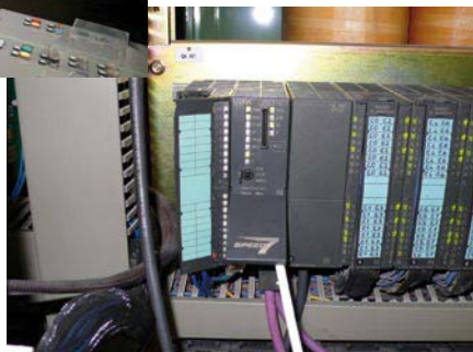
Sotto: PLC VIPA S7 installata al posto della Cpu S7-315 che garantisce il ricambio anche della Cpu di macchina 3.
